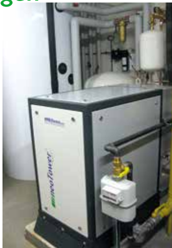
Äußerlich unspektakulär, aber hocheffizient: das neue Blockheizkraftwerk im Tura-Vereinszentrum
